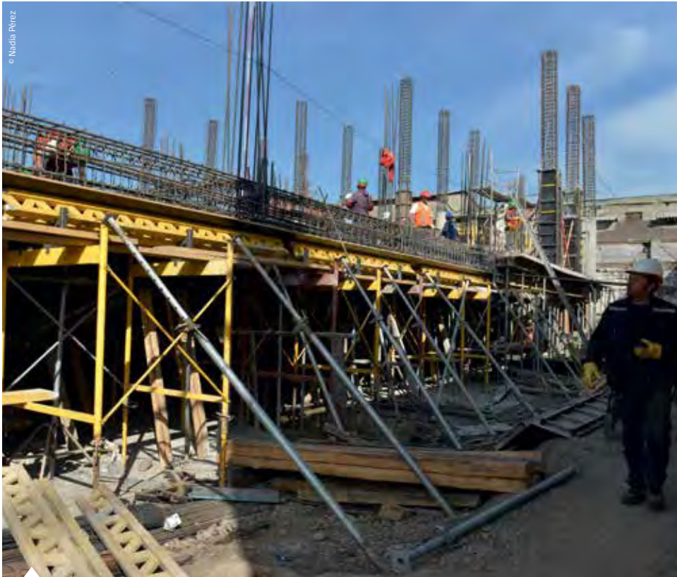
Se espera que durante el primer trimestre de 2014 sea entregada la primera etapa del nuevo edificio de la Onemi.
