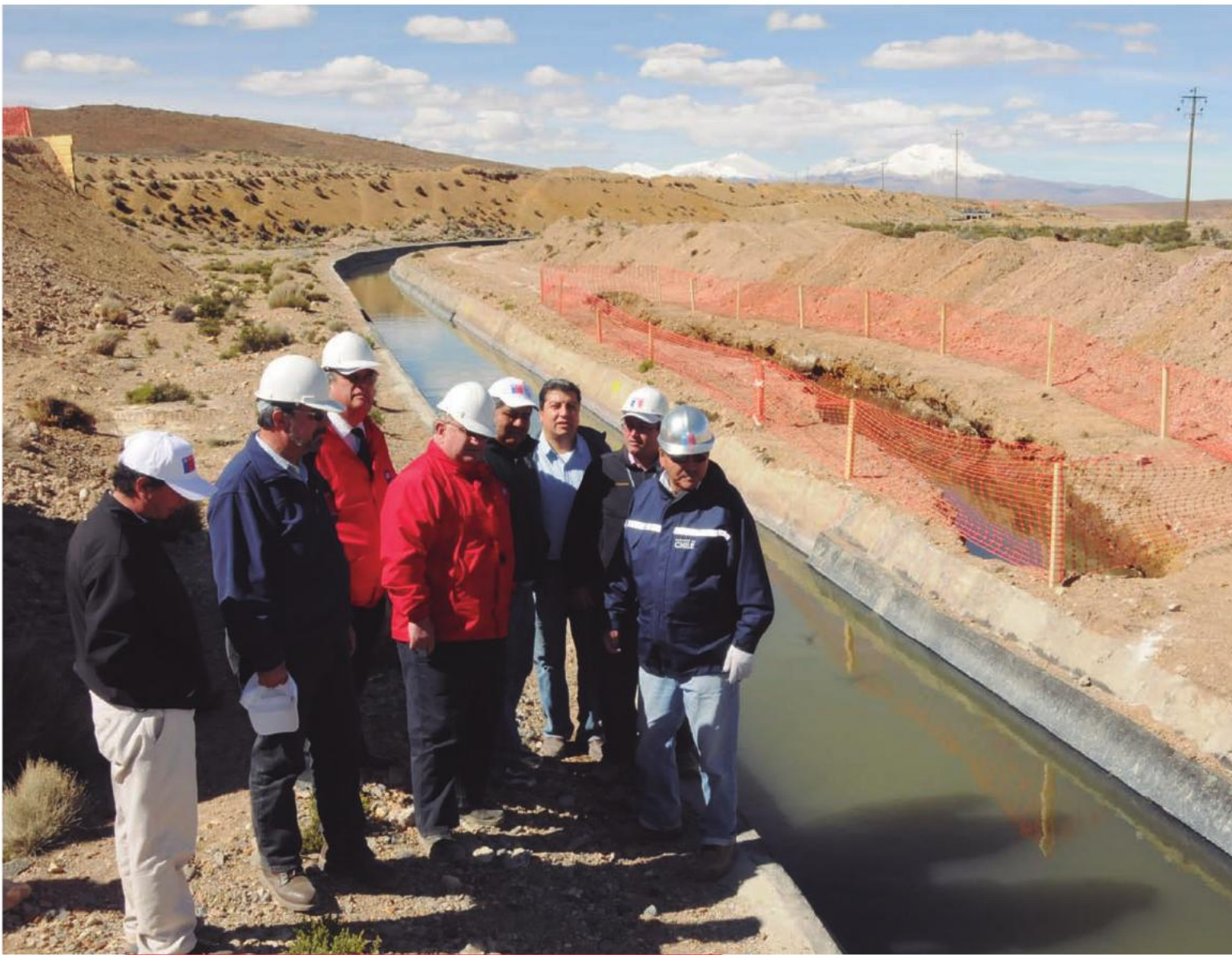
Autoridades regionales durante una visita de inspección a los trabajos de mejoramiento del canal Lauca. 14 de junio de 2012.
