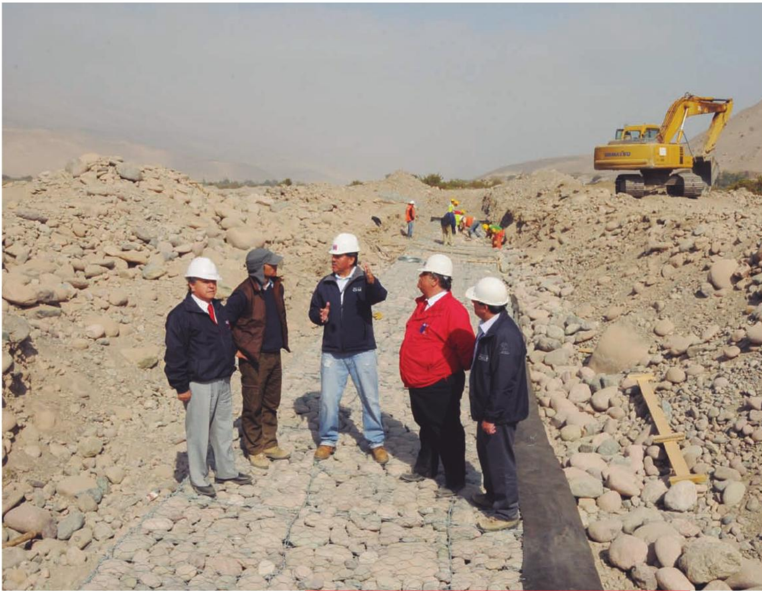
El gobernador de Arica, Patricio López, durante una inspección a las obras de reforzamiento del canal de Azapa. 5 de septiembre de 2012.
